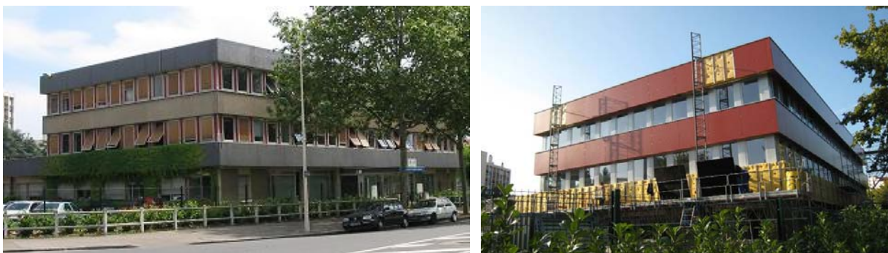
Figure 1 : Photos du bâtiment de l'ALLP : à gauche avant rénovation; à droite en cours de rénovation
