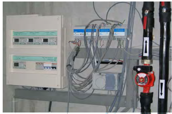
Figure 3 : vue d'une partie du système de métrologie
