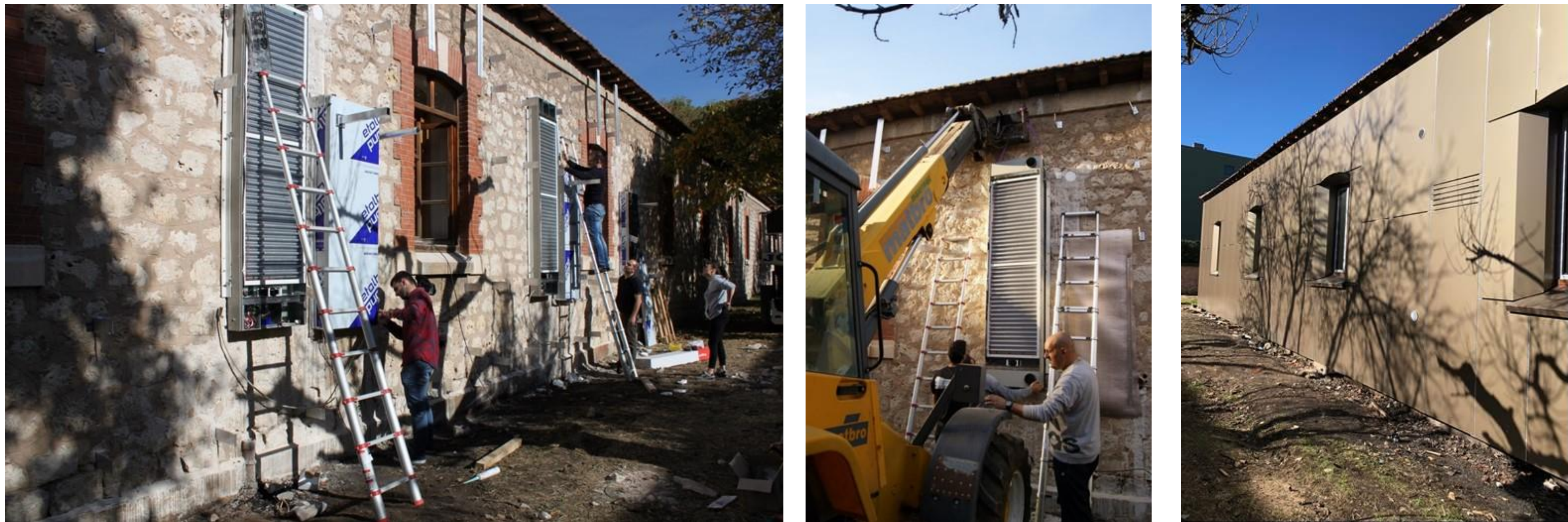
Figure 10: Installation du LHTES sur le site pilote à Burgos (gauche et centre) et résultat final (droite)
